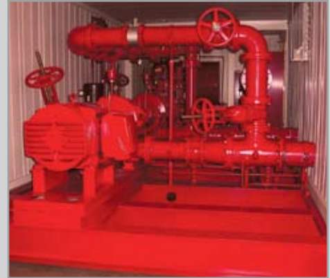
Unidad completa en una cubierta.
