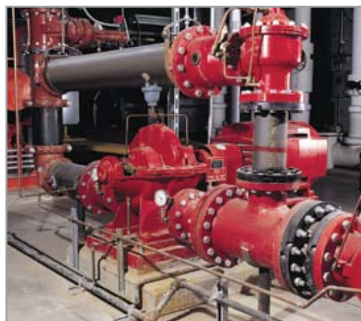
Instalación segura y protegida.
