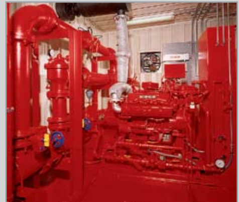
Unidad Pre-pac en una cubierta.
